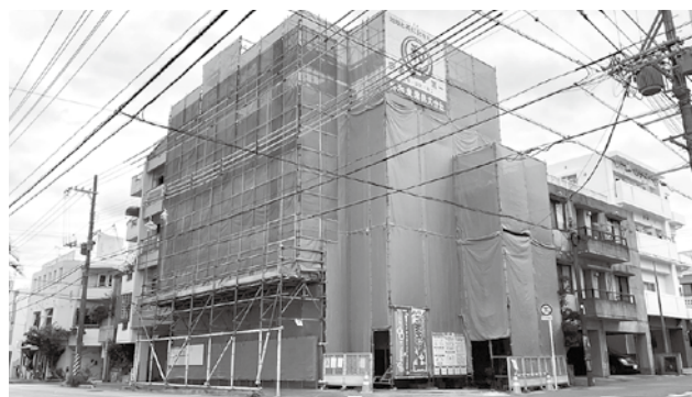
現場名：中松氏店舗兼共同住宅新築工事 品質・工程・安全管理補助
