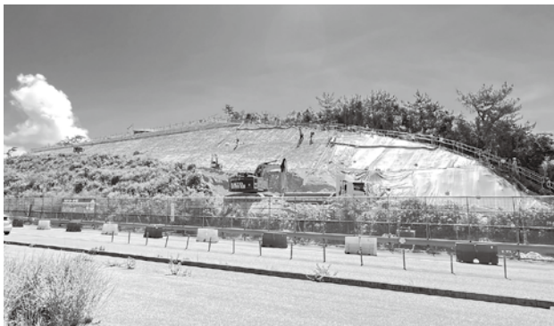
工事名：令和3年度恩納南BP2工区改良(その2)工事 主に安全管理、写真管理
