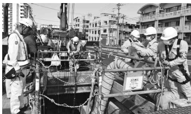
墜落防止器具の使用状況などを確認した は「歩行者道路に誘導員を置くなど、第三者に配慮した安全対策がしっかりと行われていた」講評した。
