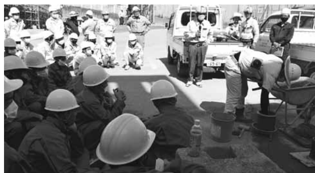
県立那覇A特別支援学校新築工事現場ではコンクリート試験の様子を見学
