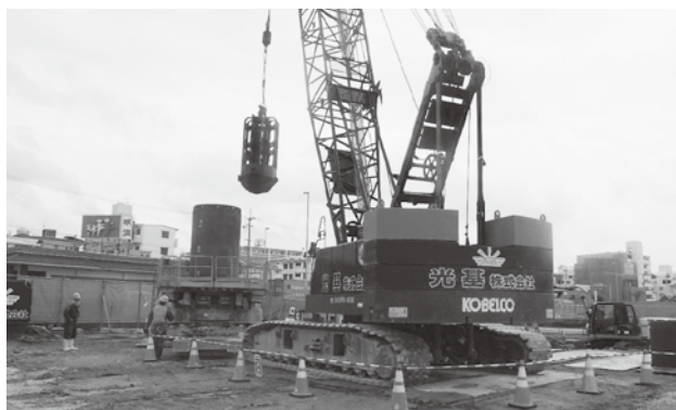
小禄道路橋梁下部工の基礎となる杭、場所打杭の施工状況。
